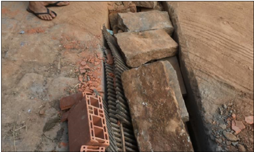
SEGUNDO os moradores a vala no meio da rua foi feita de maneira irregular
