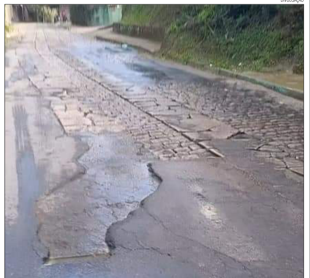
DESNIVELAMENTO da rua e falta de asfalto em vários pontos prejudicam o trânsito
