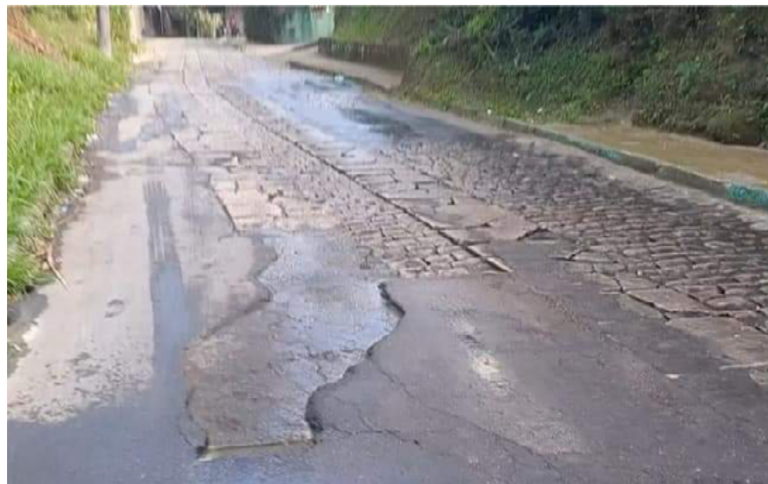
PROBLEMAS no asfaltamento da João de Deus prejudicam o trânsito de veículos e pedestres
