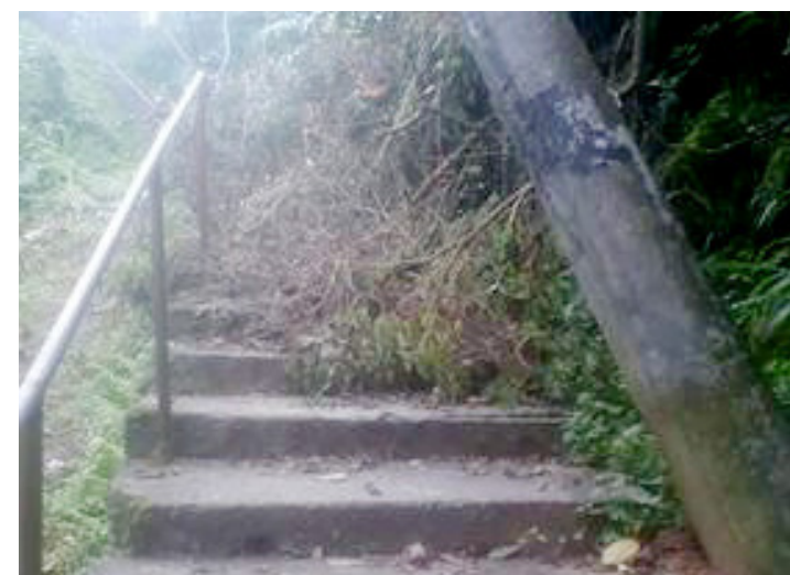
BARREIRA impede a passagem de pedestres na Rua do Túnel
