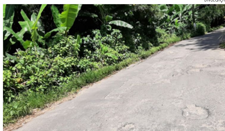
MUITOS buracos em toda a extensão da rua prejudicam moradores
