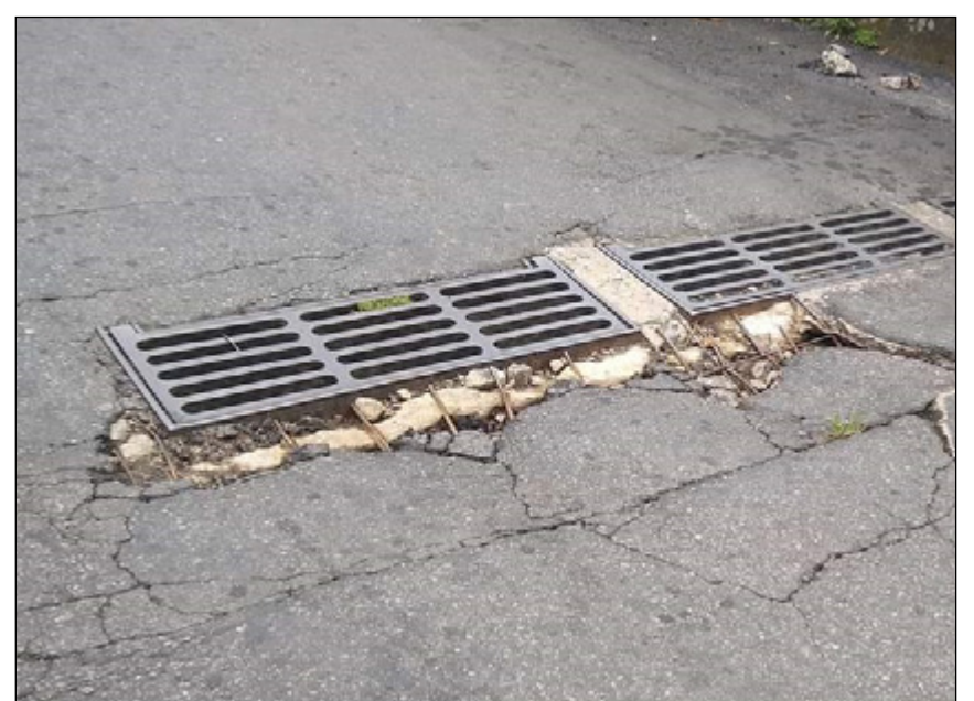
MORADORES disseram que o asfalto está danificado e rua estaria cedendo
