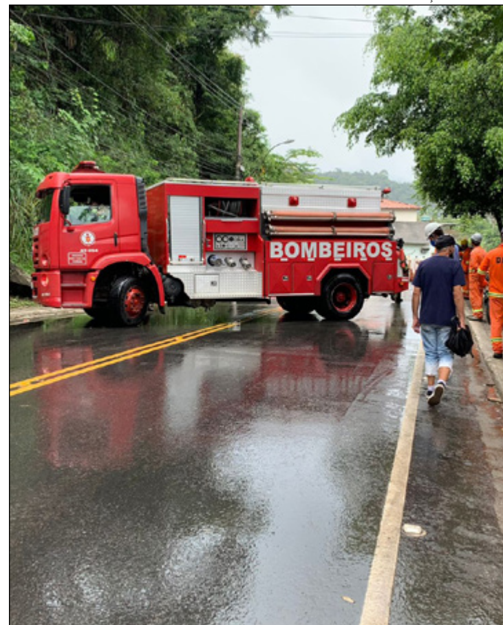
A TUBULAÇÃO de gás foi quebrada próximo de um posto de gasolina
