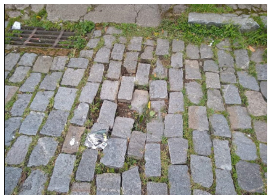
MOTORISTAS pedem manutenção viária em rua que faz ligação de dois bairros
