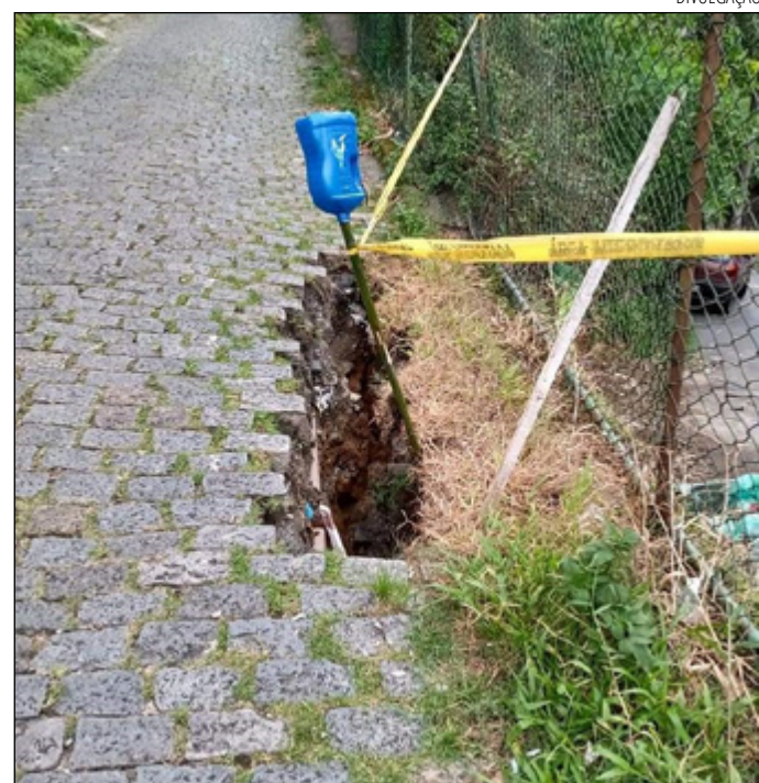
RUAS com buracos e calçadas com mato prejudicam moradores
