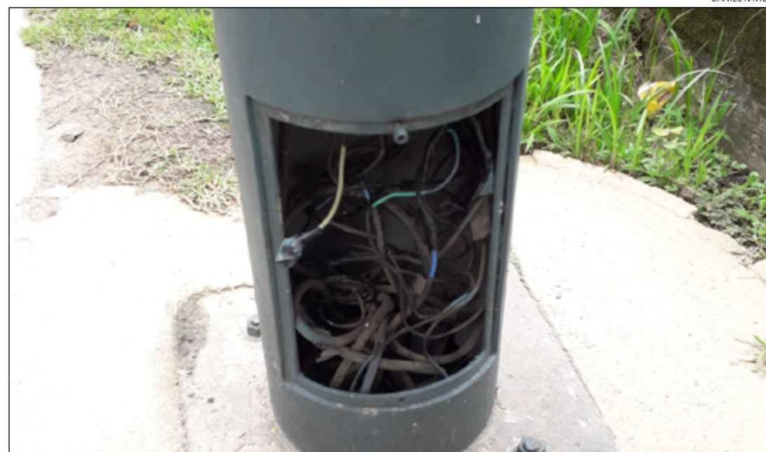
A FIAÇÃO exposta fica em um poste em frente ao prédio dos Correios, local de grande movimento
