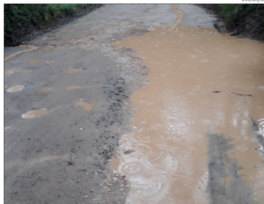
SEM calçamento, a Estrada do Brejal acumula problemas como buracos e lama
