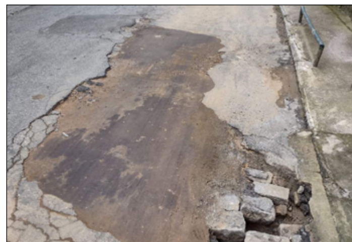
APÓS conserto de tubulação parte da rua está afundando
