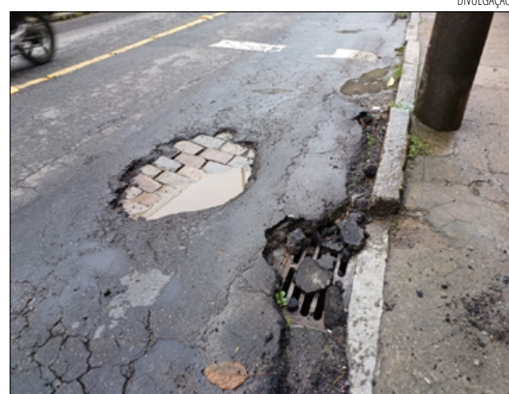
BURACO NO meio da rua complica o trânsito na Fonseca
