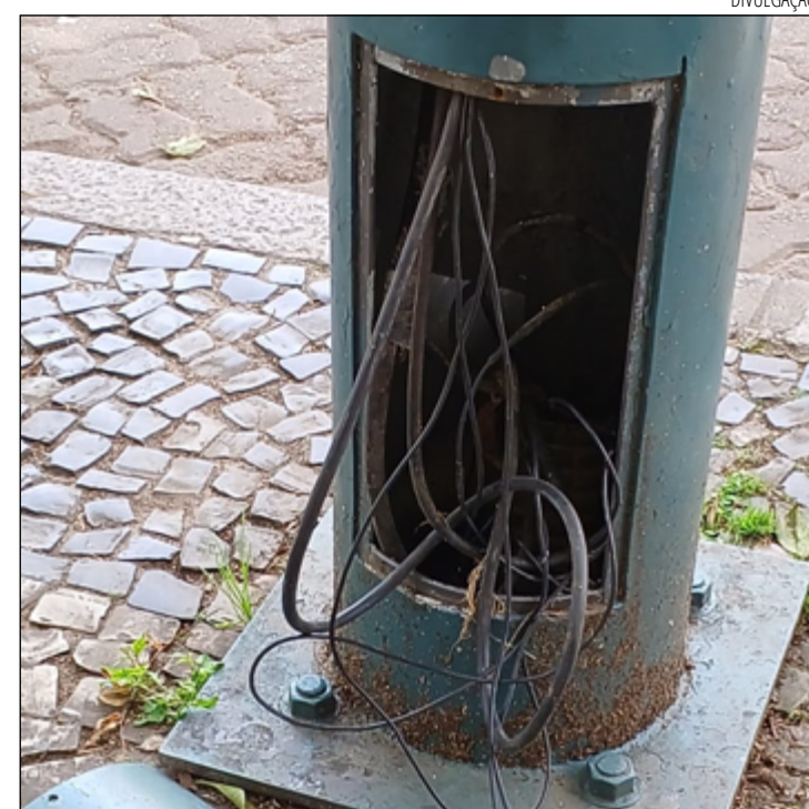
FIAÇÃO desprotegida pode causar acidentes na Praça D. Pedro
