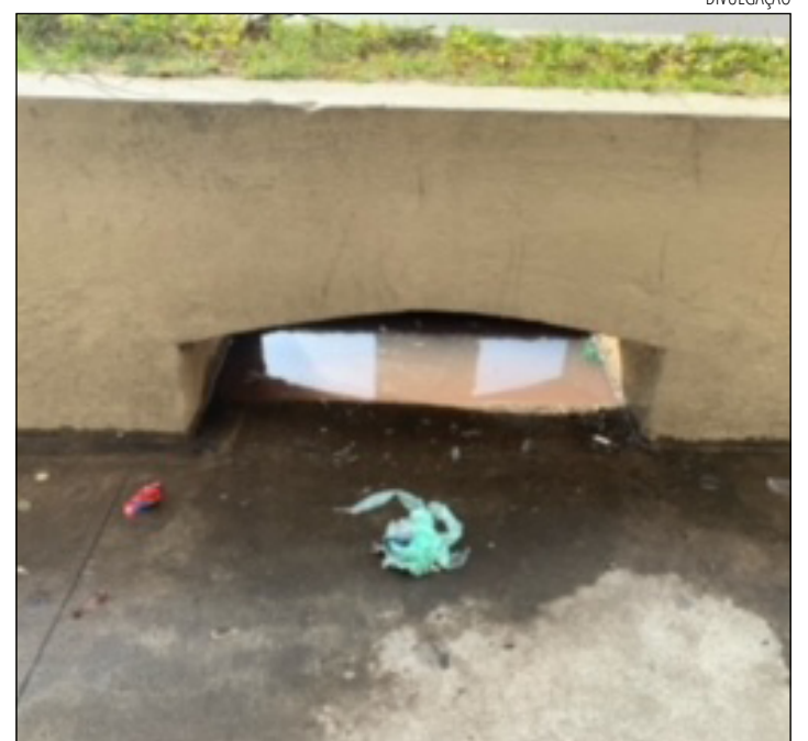
ALÉM do mau cheiro, os bueiros entupidos causam alagamento
