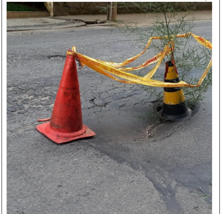
BURACO na Nelson de Sá Earp complica ainda mais o trânsito
