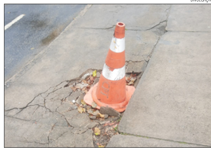
BURACO no Centro da cidade atrapalha trânsito de pedestres
