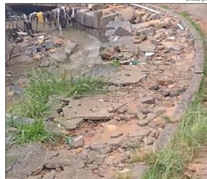
COM calçada destruída moradores precisam caminhar na rua
