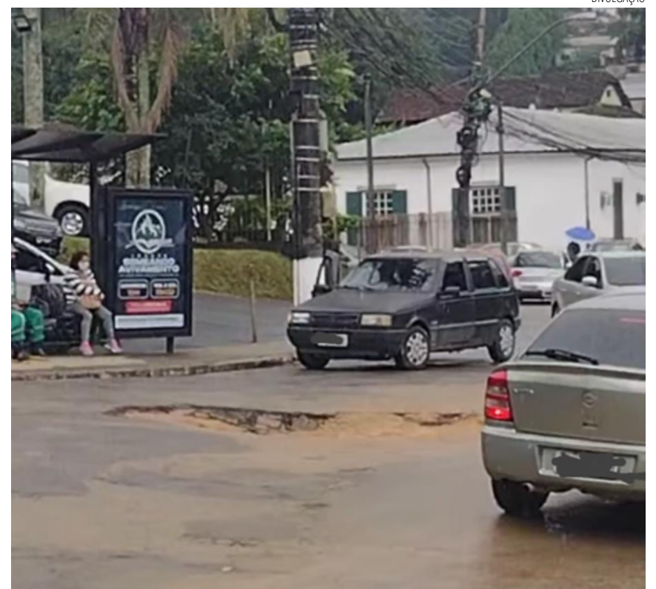
UM GRANDE buraco se abriu na entrada das duas ruas e dificulta a passagem
