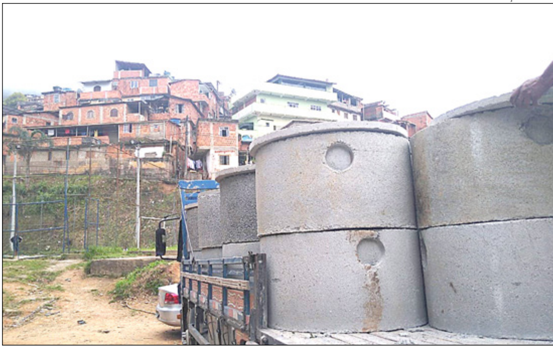
O MATERIAL vai possibilitar o tratamento de esgoto residencial na localidade
