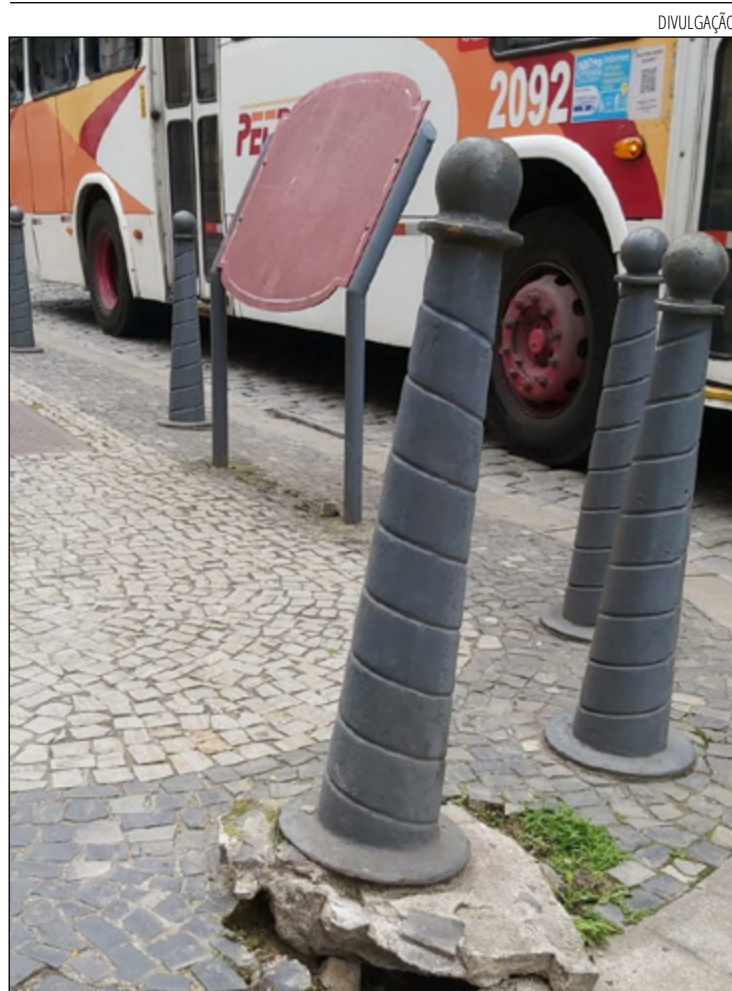
O MOBILIÁRIO está solto na calçada e pode causar acidentes
