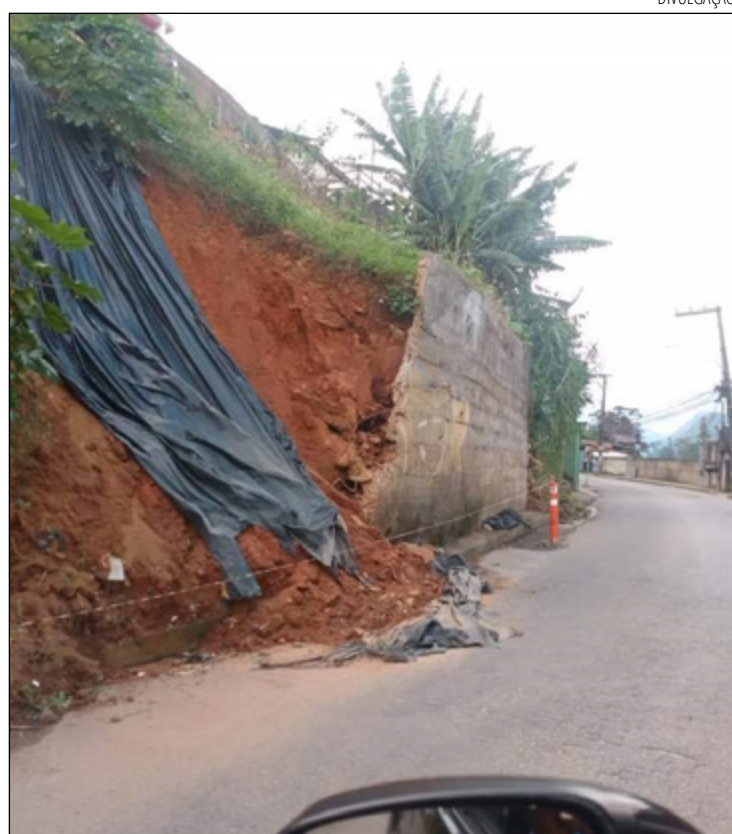
PARTE DO muro já caiu e há apreensão sobre mais quedas
