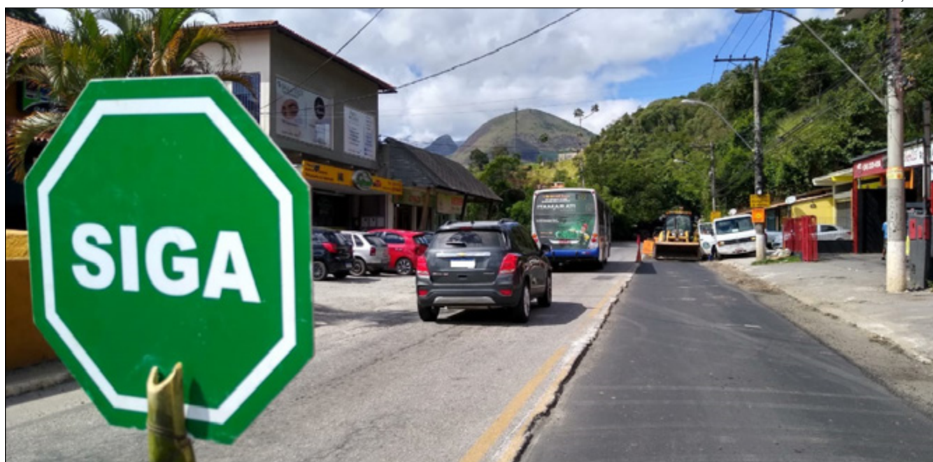
OBRAS DA Águas do Imperador na União e Indústria serão executadas à noite para minimizar impactos no trânsito
