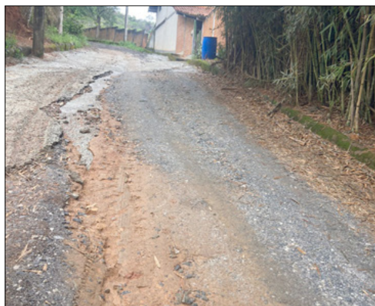
FALTA DE pavimentação e de iluminação na rua são problemas
