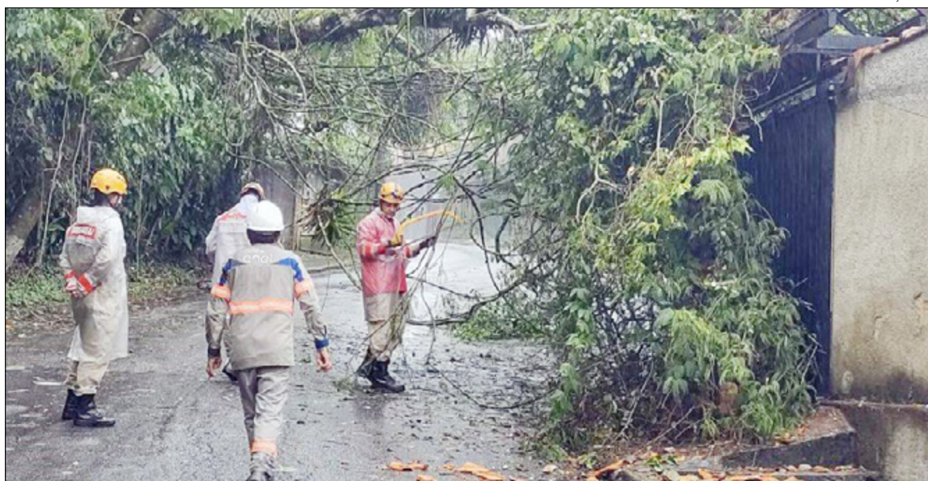
NA RUA RIO de Janeiro, houve uma queda de árvore que deixou a via interditada e afetou a instalação elétrica do local
