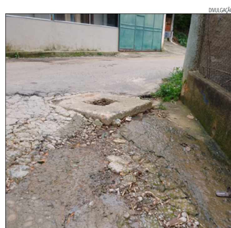
SEGUNDO moradores, a tampa do bueiro está quebrada e solta
