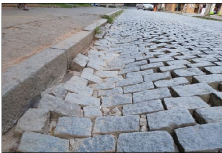
NO PONTO de ônibus é possível ver o afundamento da rua
