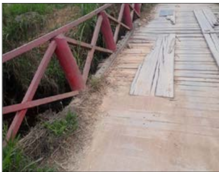
FOTO MOSTRA a precariedade na estrutura da Ponte na Posse
