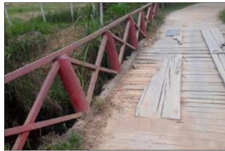
PONTE EM péssimo estado preocupa moradores do local
