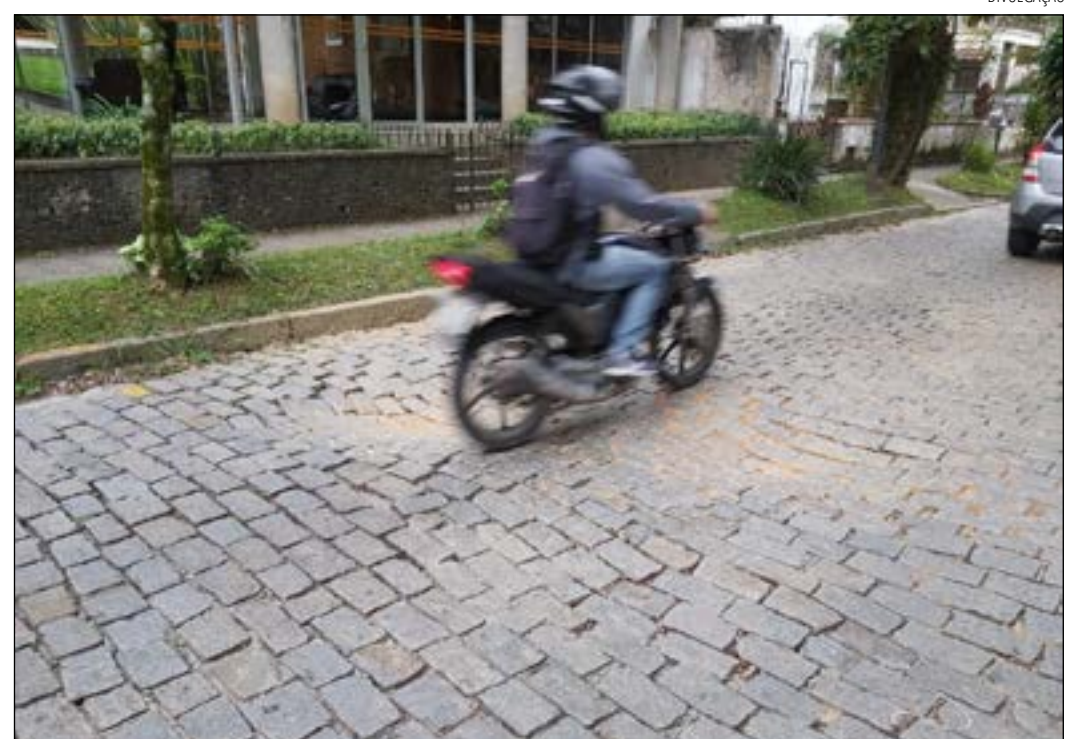
O AFUNDAMENTO da pista faz com que os motoristas necessitem de maior atenção
