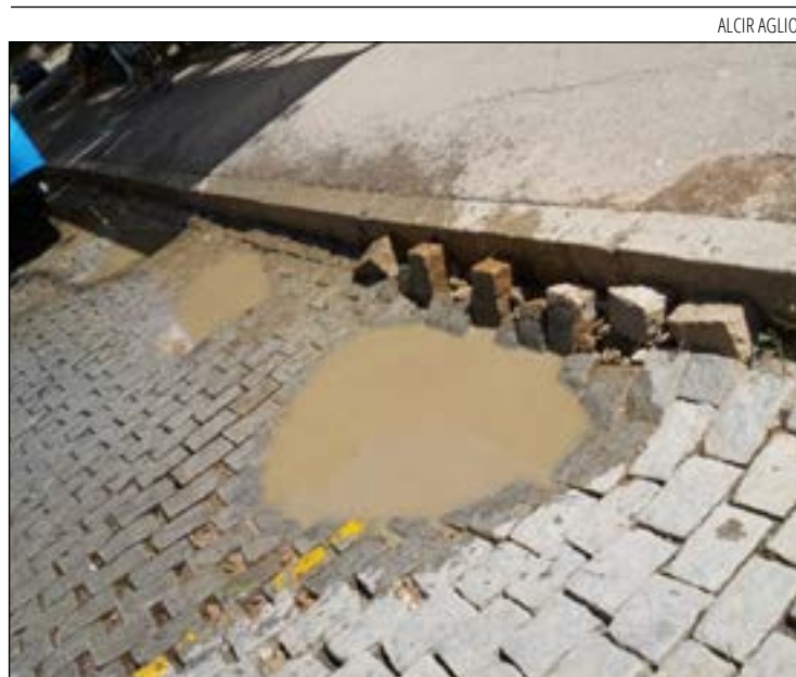
DESNIVELAMENTO da rua no ponto de ônibus não foi resolvido
