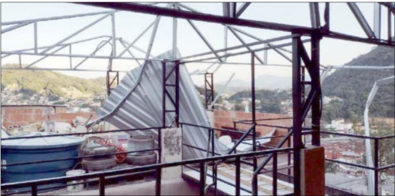
PROJETO DO Morro, que funciona no Alto da Serra, teve o telhado danificado por uma forte ventania e precisa de ajuda
