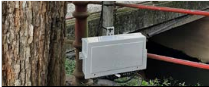
CAIXA FOI recuperada pela concessionária de energia elétrica
