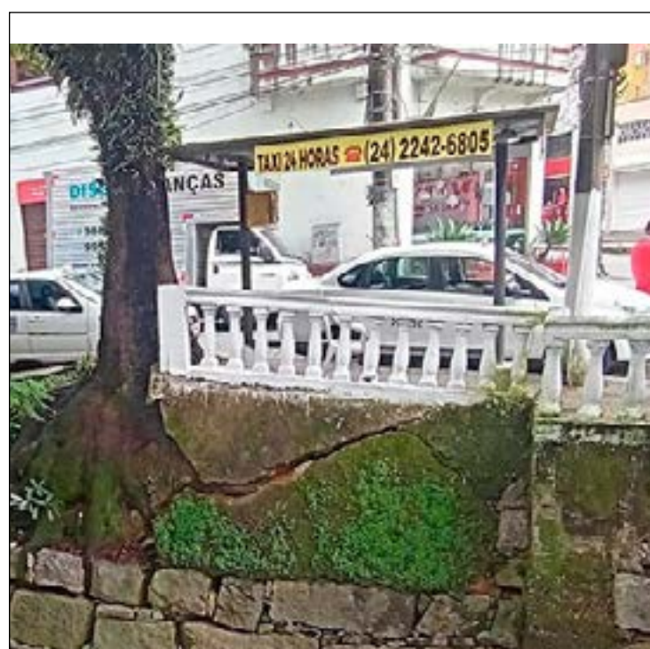
TAXISTAS temem que parte da rua desabe para dentro do rio
