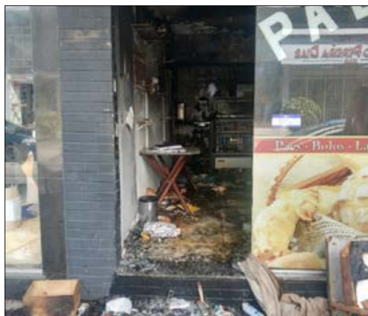
PADARIA ficou destruída após um incêndio no último domingo
