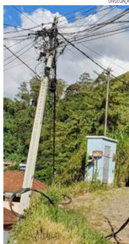
FIÇÃO está caída em rua do Floresta
