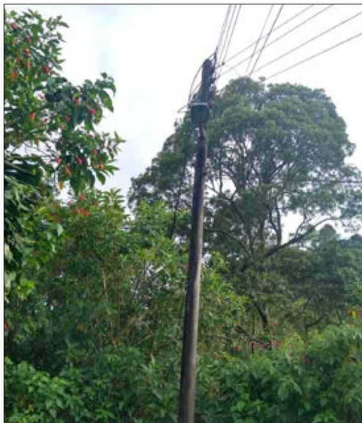
POSTES da localidade apresentam problemas nas lâmpadas
