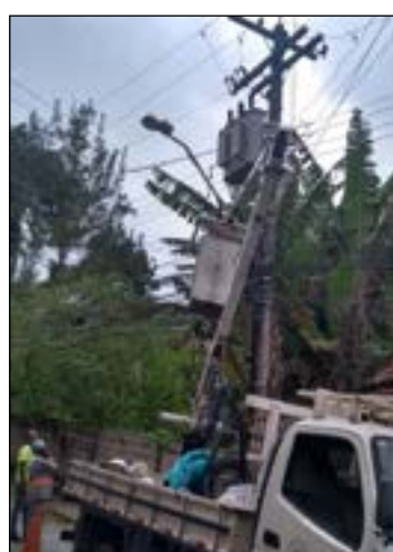
FIOS de telefonia estavam caídos
