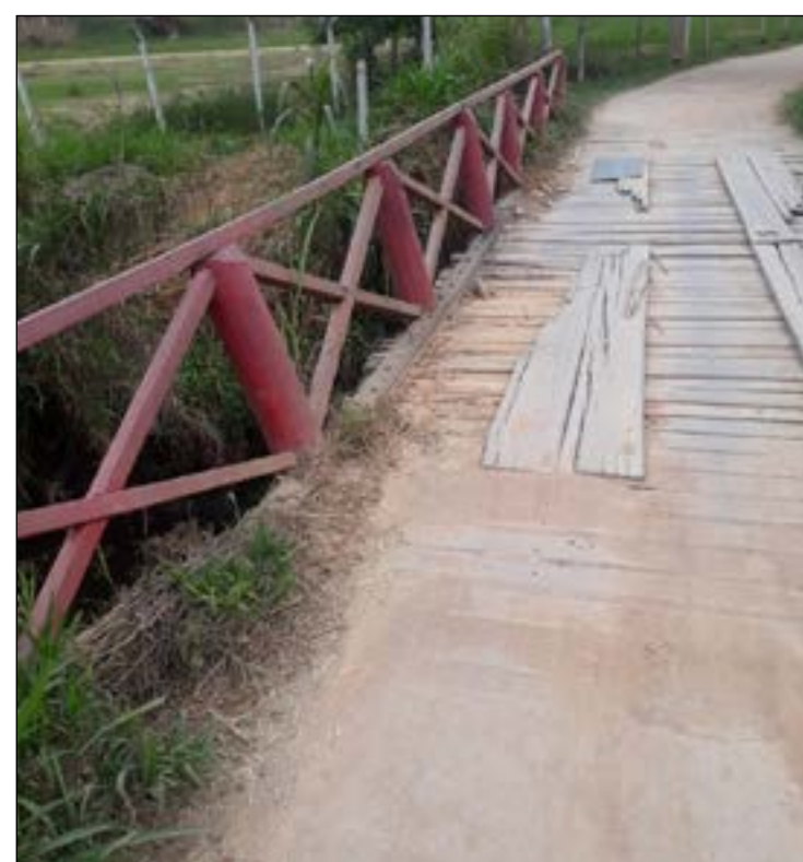
A RECOMENDAÇÃO é para que veículos pesados não trafeguem
