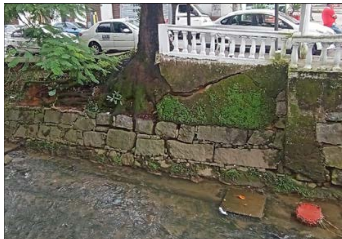
PARTE DA calçada da Rua Professor Pinto Ferreira, no Centro, está cedendo para dentro do rio
