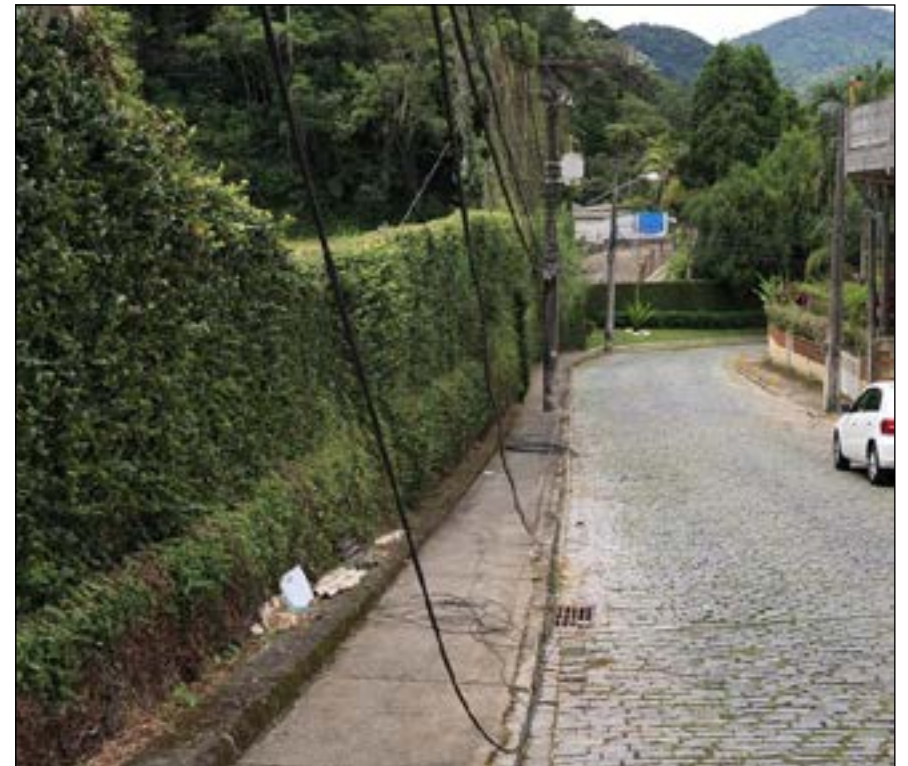
A PREFEITURA consertou a luminária do poste, mas os fios continuam caídos
