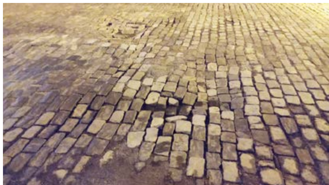
OS PARALELEPÍPEDOS saíram do alinhamento e se formou um buraco no meio da via
