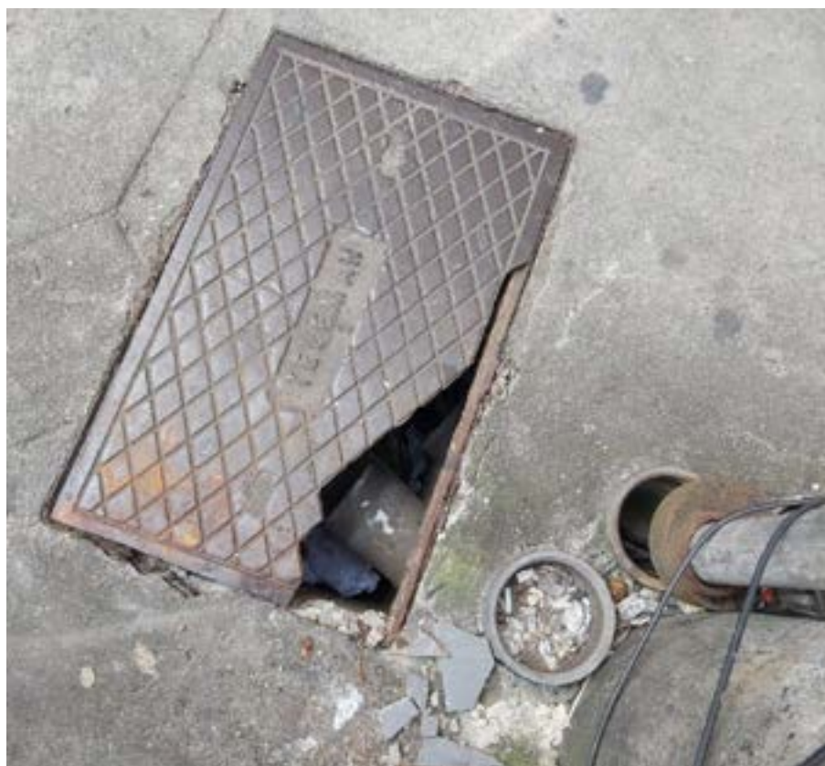
A TAMPA da caixa de telefonia na calçada da Rua Joaquim Moreira está quebrada
