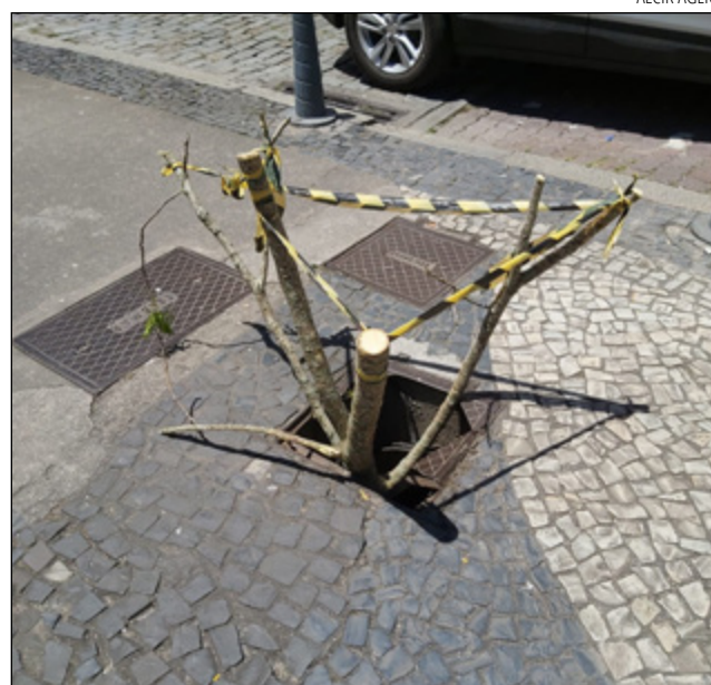
BURACO no calçadão do Cenip foi sinalizado com galhos
