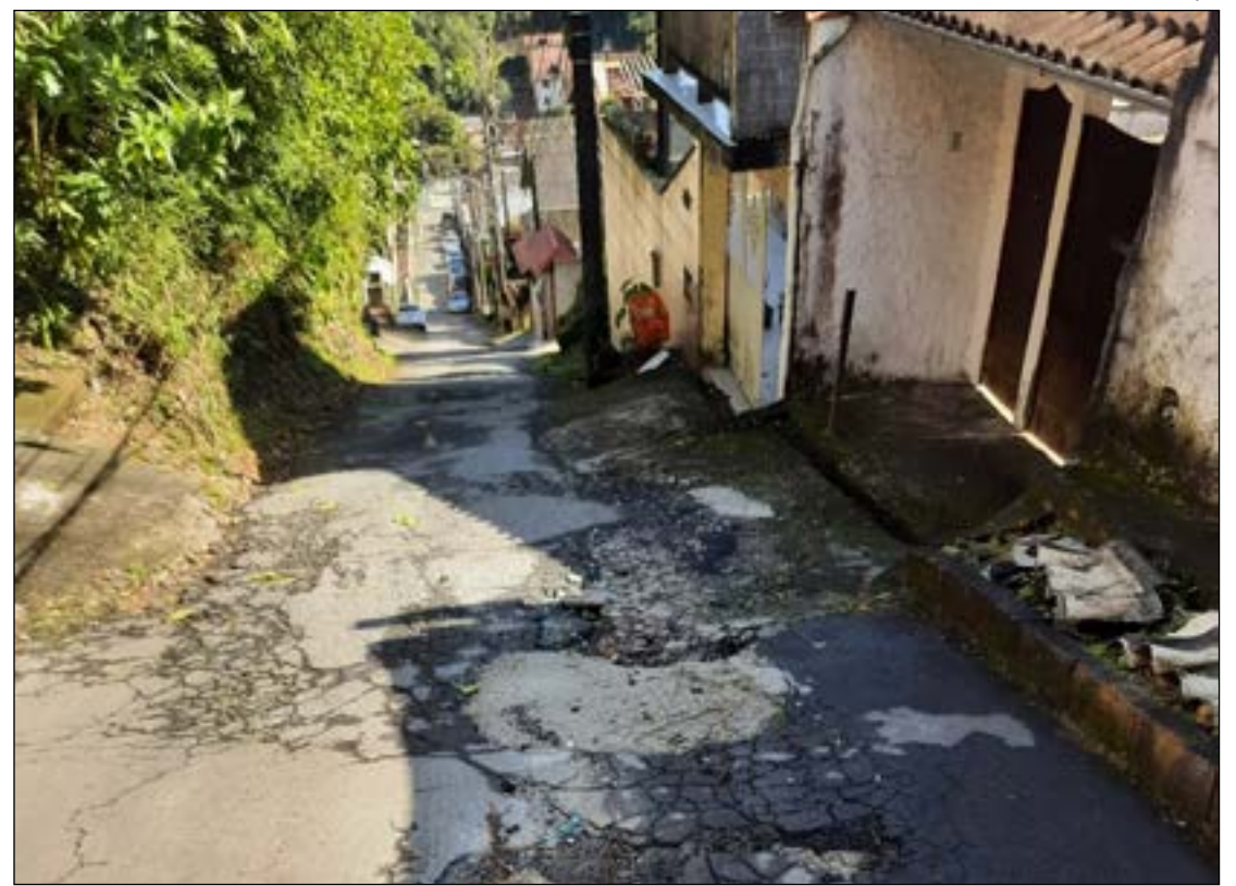
RUA QUE fica no bairro Castelânea ficou ainda mais danificada por conta da última chuva forte
