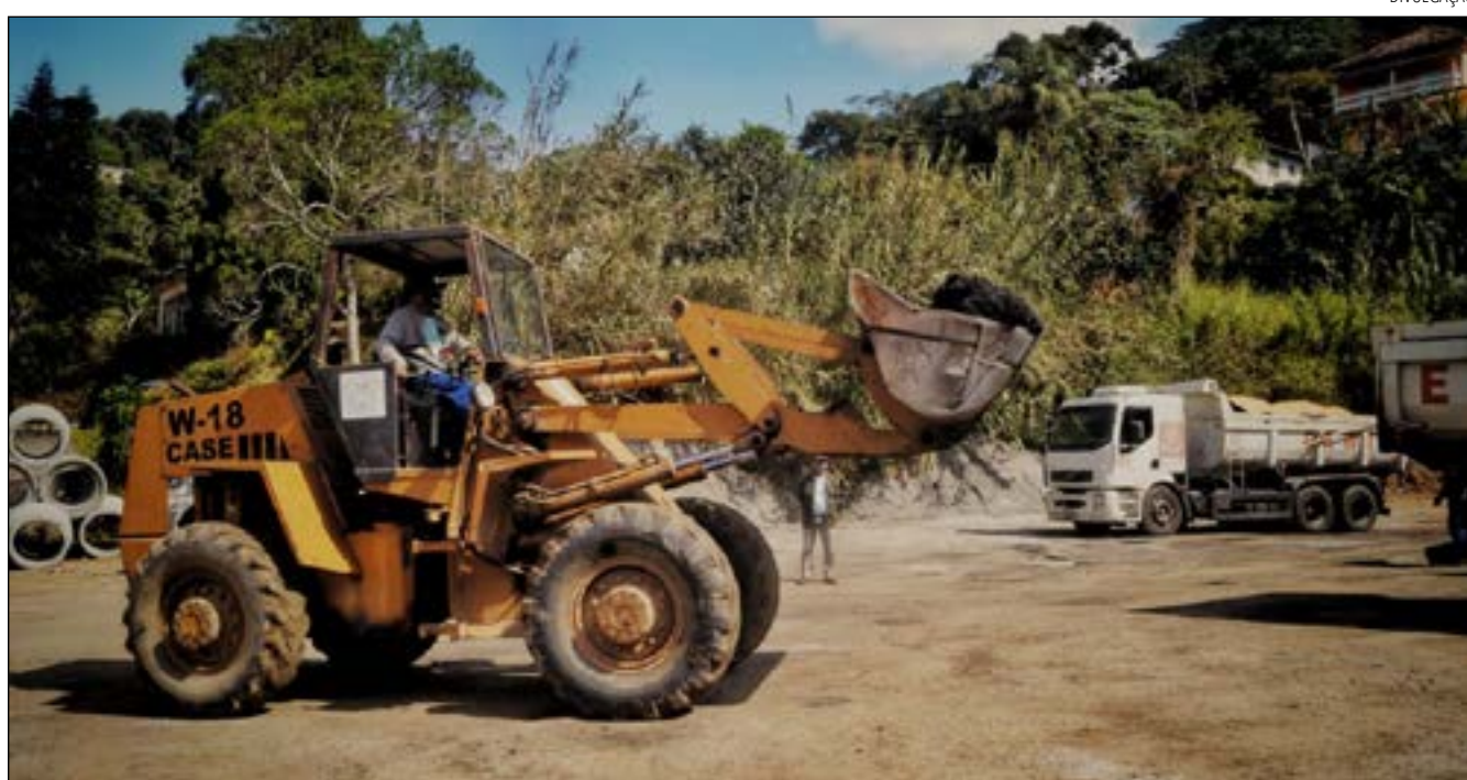
REATIVAÇÃO DA usina vai permitir que a cidade produza o próprio asfalto, que além de agilizar serviços gera economia
