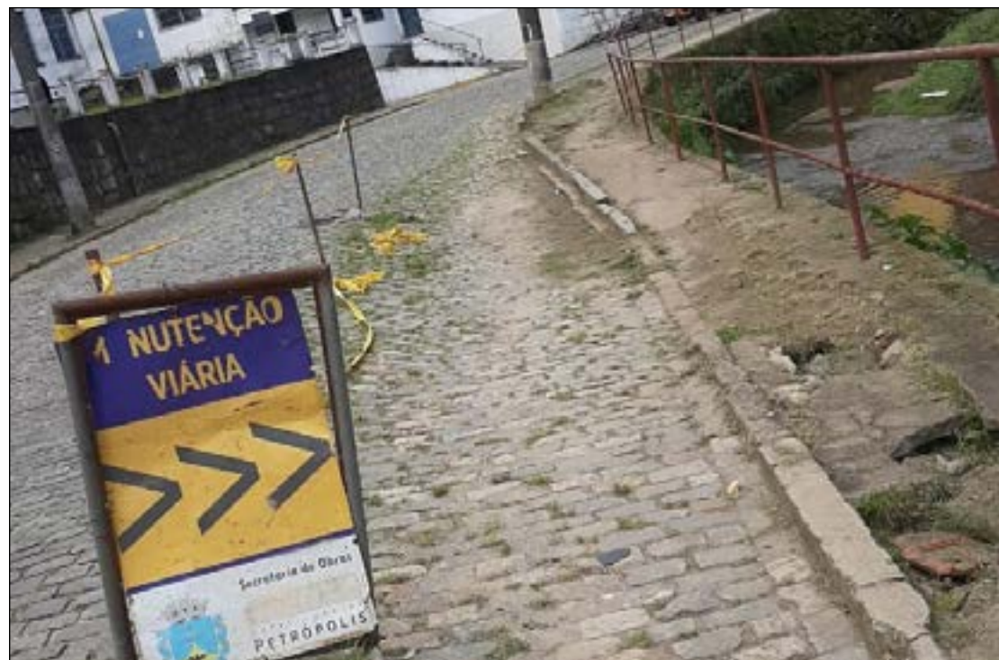
APENAS A interdição foi feita há mais de dois anos, mas as intervenções não chegaram a ser realizadas
