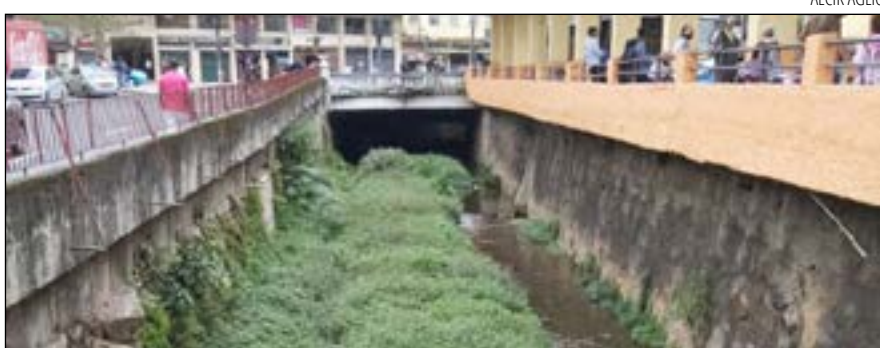
NO TÚNEL extravasor, no Centro, já é possível perceber acúmulo de lixo
