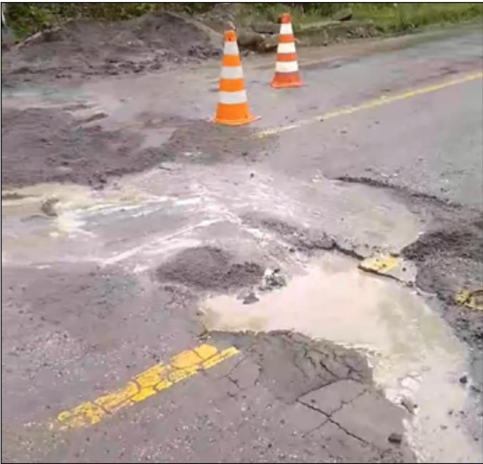
MOTORISTAS e alunos de autoescolas reclamam da vala na rua
